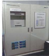
学校用(蓄電池付き) 太陽光発電システム
