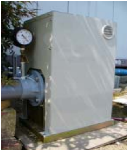
水力発電機本体
